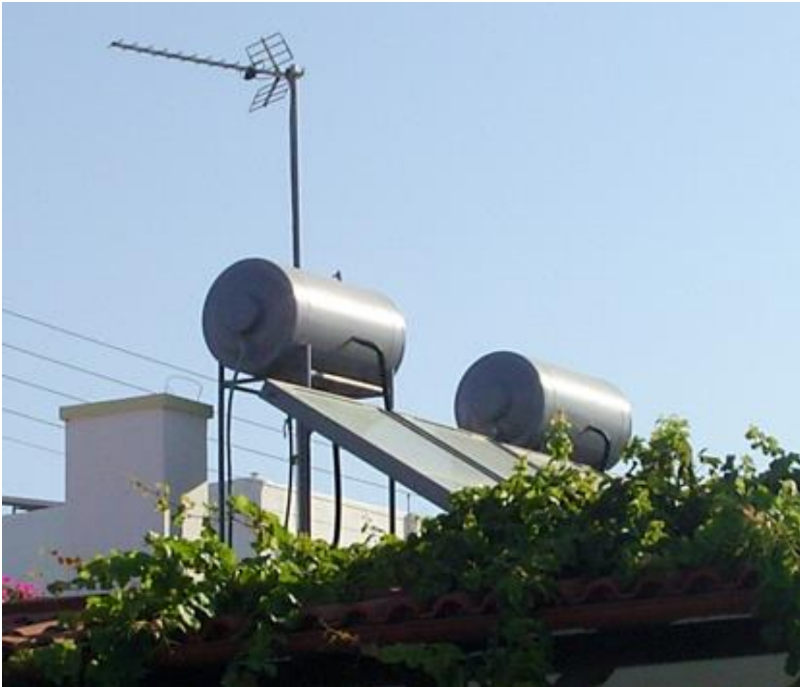
Fig.26 Installation d'un chauffe-eau solaire en Crète (35 °N). La position inclinée des capteurs favorise l'éclairement hivernal.
