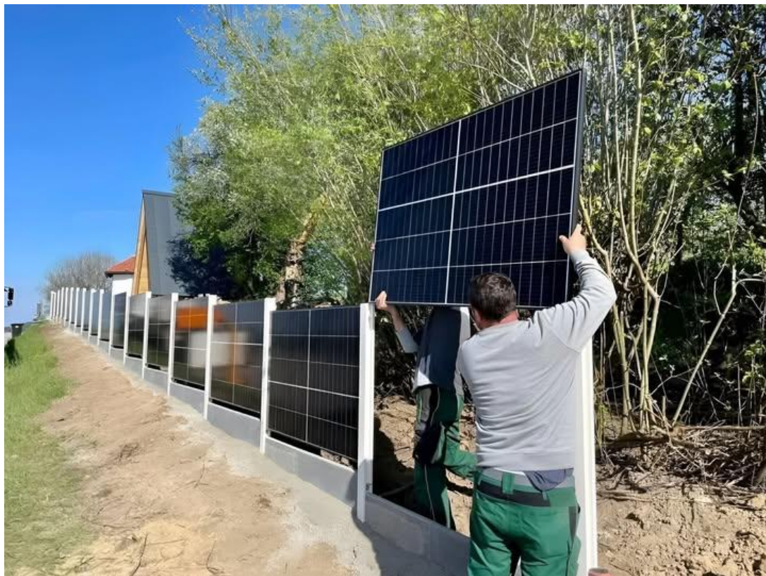
Fig.25 Installation de panneaux photovoltaïques, ici en Allemagne, en position verticale. La production hivernale est favorisée, au détriment du rendement estival.
